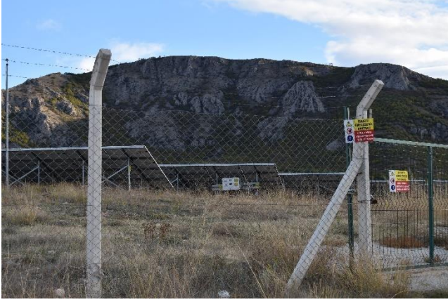
Şekil 2. 13. Güneş Enerji Santralleri Bölgesi (Orijinal, 2024)
